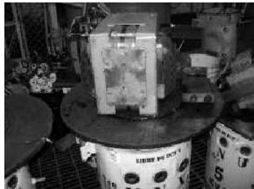
Figura 12: Transformador fallado por Defecto de Fabricación
