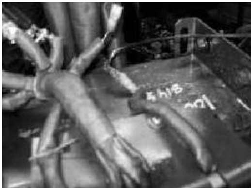
Figura 10: Transformador fallado por Humedad
