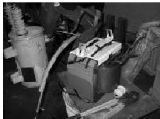
Figura 4: Transformador fallado por Sobre tensión Atmosférica
