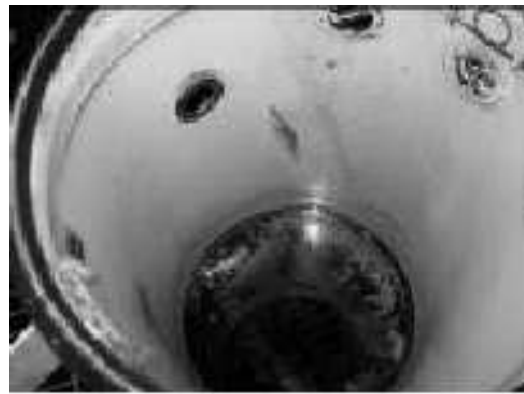
Figura 3: Apariencia del aceite dieléctrico de este transformador fallado
