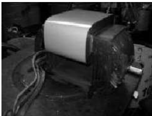
Figura 2: Transformador fallado por Sobrecarga
