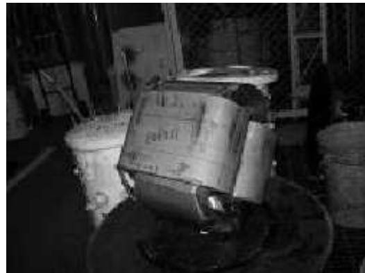
Figura 8: Transformador fallado por Defecto de Operación
