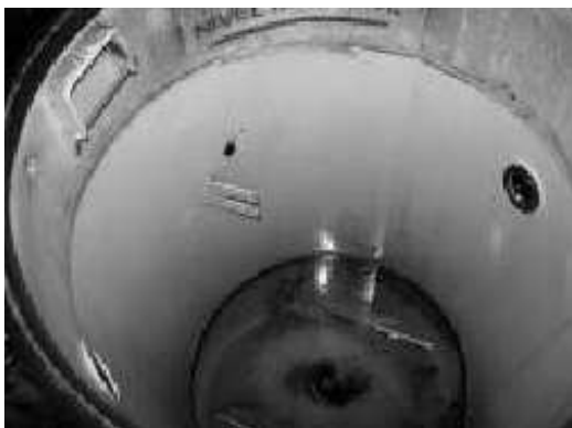
Figura 11: Apariencia del aceite dieléctrico de este transformador fallado
